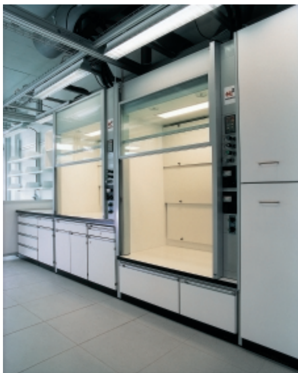
Fig. 2. Dank eingebauter Mediensäule und integrierter Abluftvolumenstromregelung ist selbst die Kapelle vollständig mobil.
